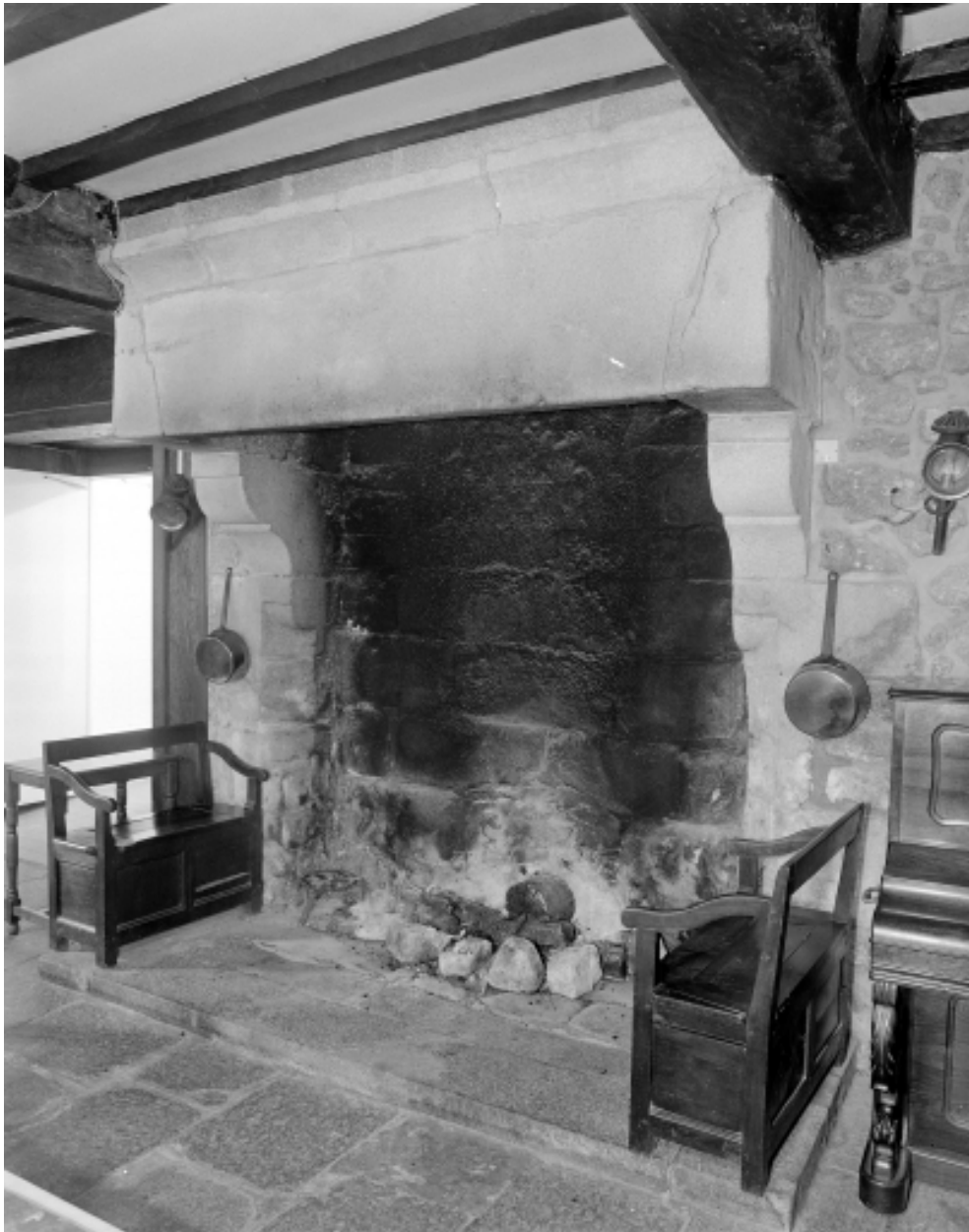
Vue générale de la cheminée, salle n°1, rez-de-chaussée avec partie basse ancienne.
