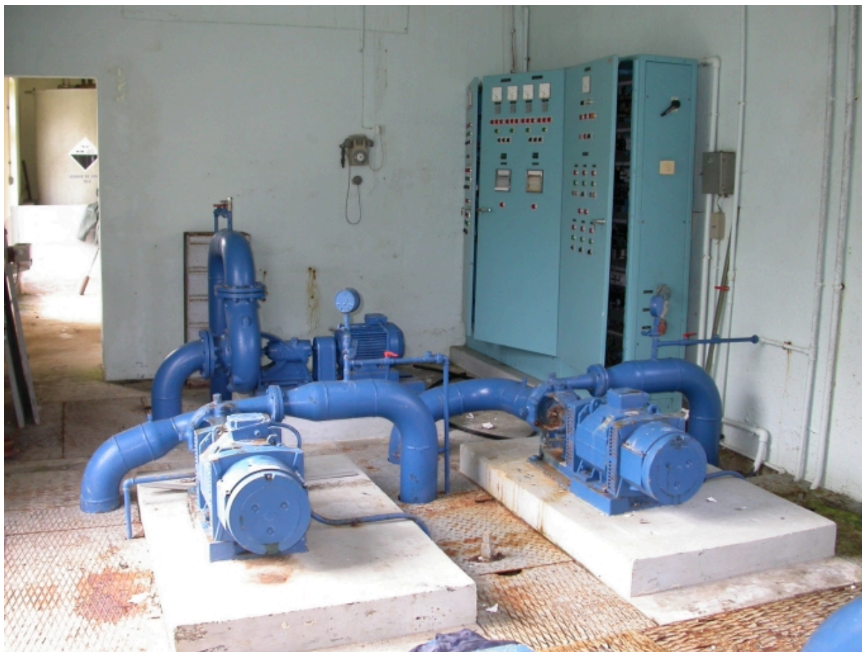
Pompes centrifuges Rateau et armoire des commandes, vue générale.
