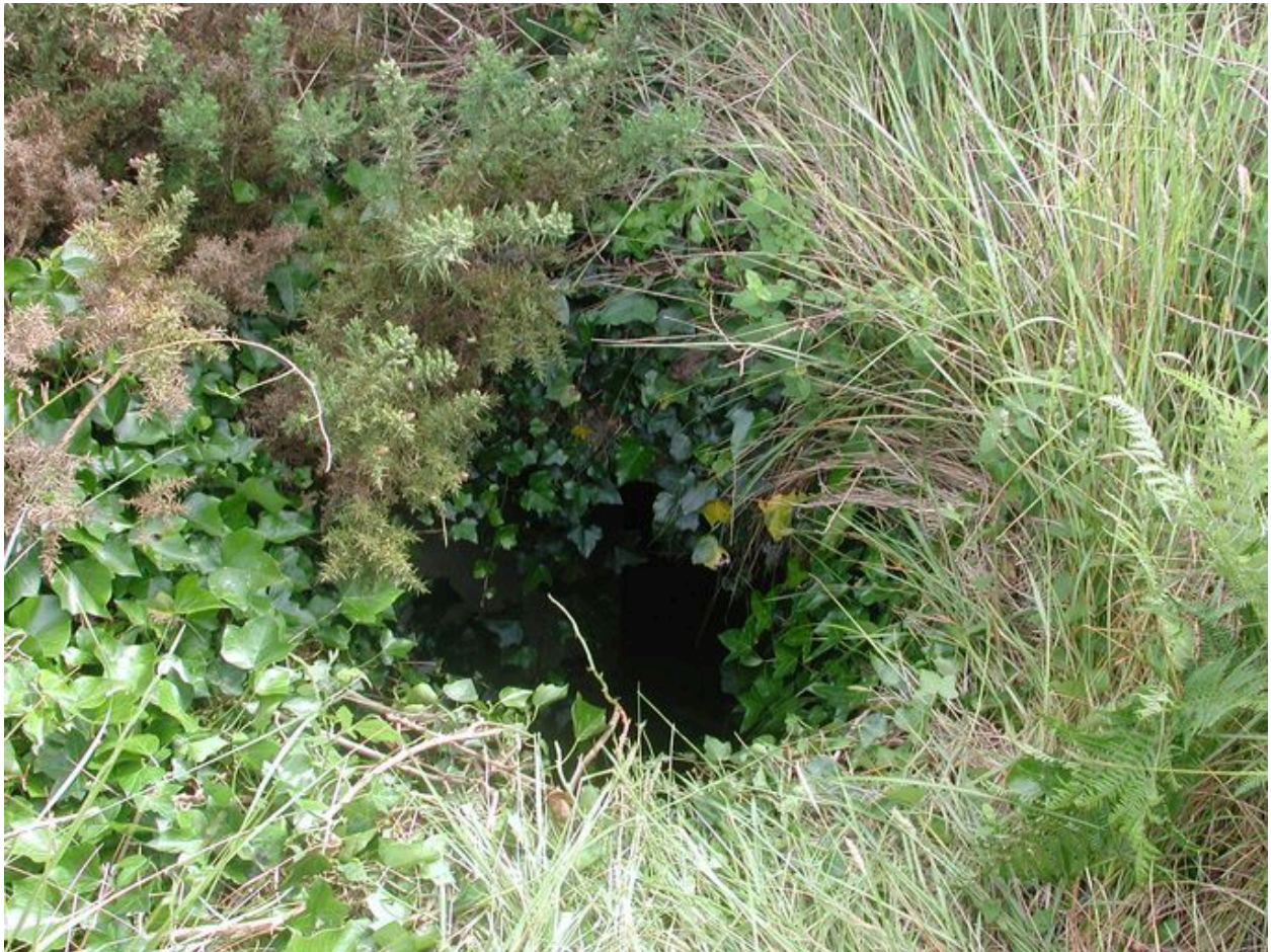
Vue du poste d'observation envahi par la végétation (état en 2003)
