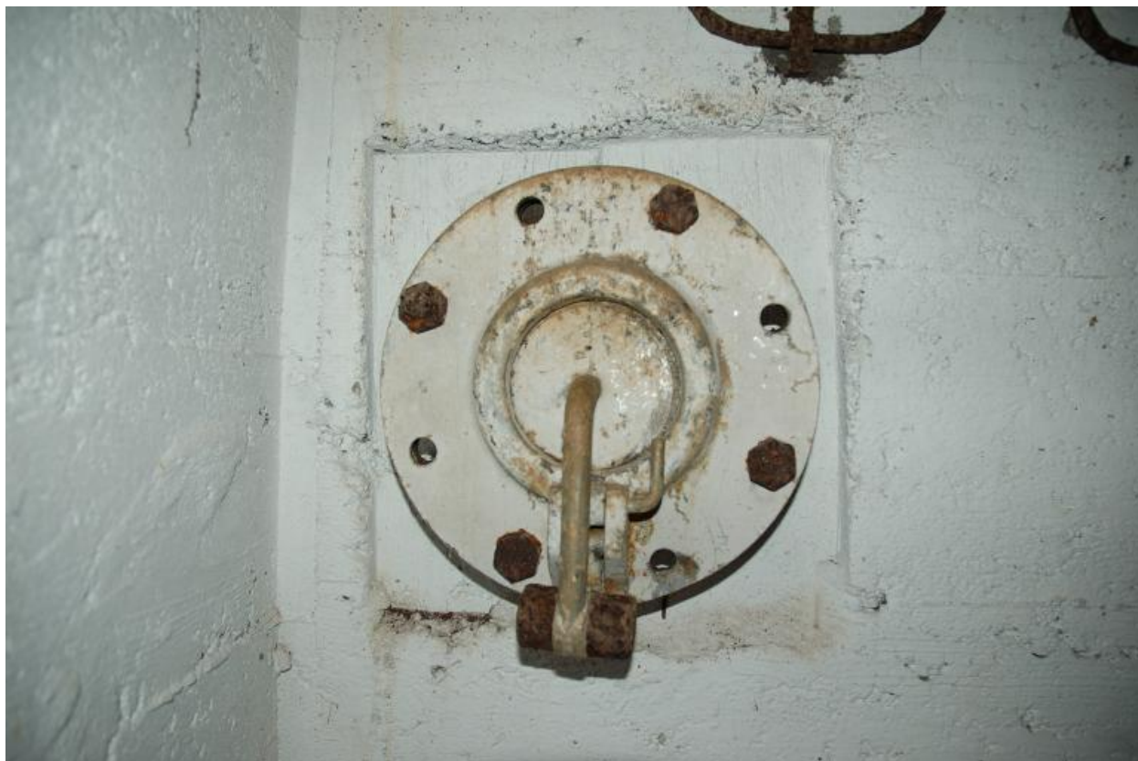
Vue de l'un des clapets de suppression (état en 2005)
