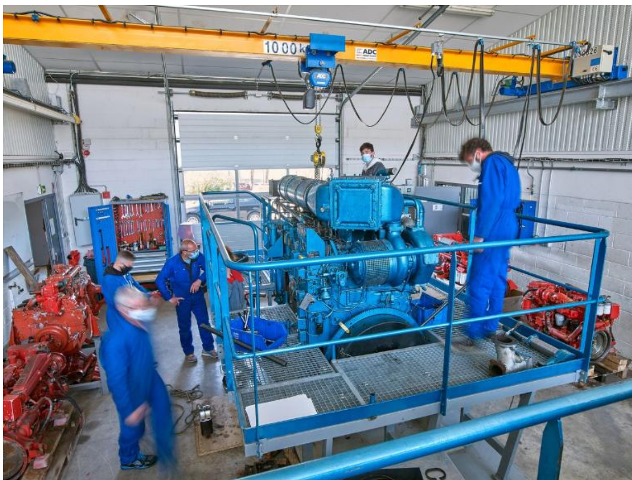
Ateliers, à Kerpallud. Vue intérieure de l'atelier moteurs.
