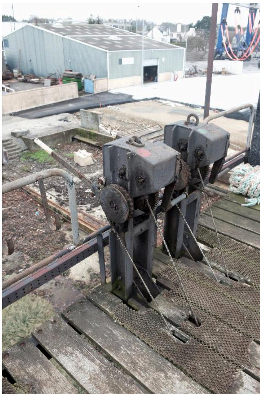
Passerelle : système mécanique
