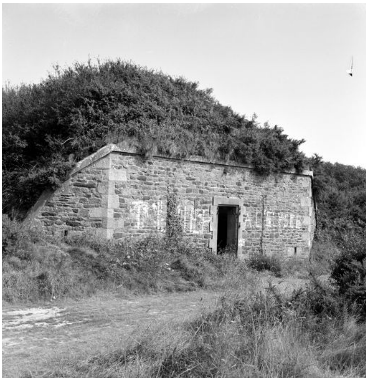
Vue de la batterie de la pointe des Espagnols en 1969 : abri-traverse de la batterie haute
