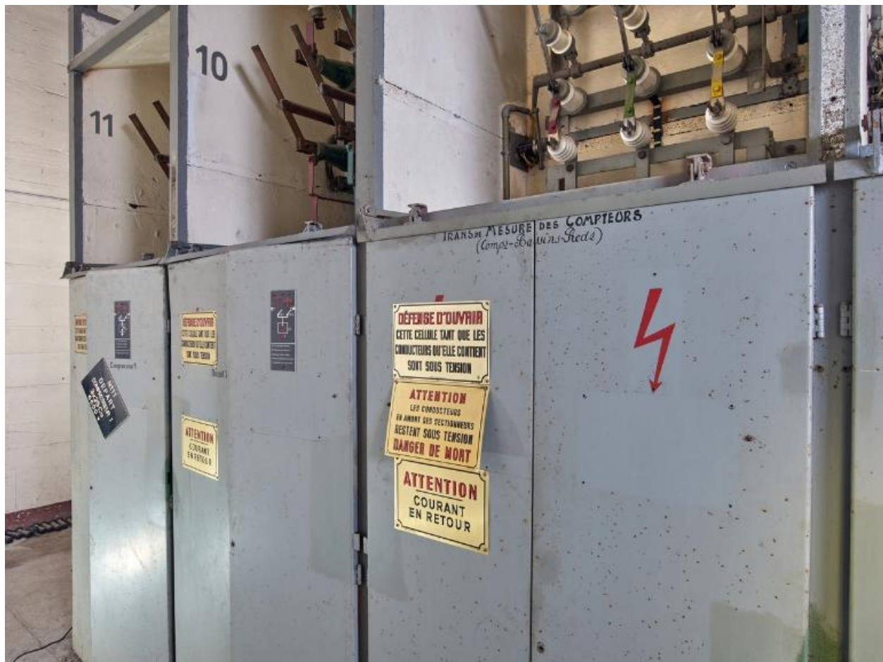
Vue des cellules hautes-tensions situées au deuxième étage : cellules n° 9, 10 et 11, plaques signalétiques et inscriptions peintes sur les portes des cellules
