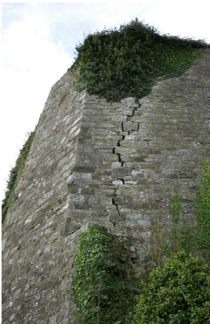
Vue du fort de Lanvéoc : demi-bastion de l'extrémité est, détail du parement, lézarde
