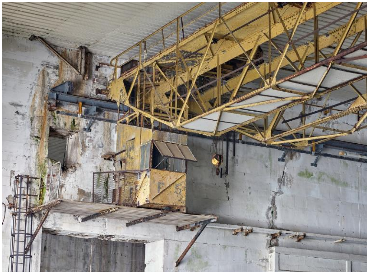
Vue du pont roulant de l'alcôve D (n° 19, 19a et 20). Sa capacité est de 5 tonnes. On peut lire l'inscription "lot 008"
