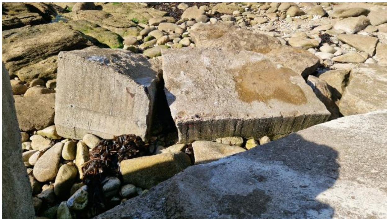
Vue de détail au sud de la grève : éléments disloqués
