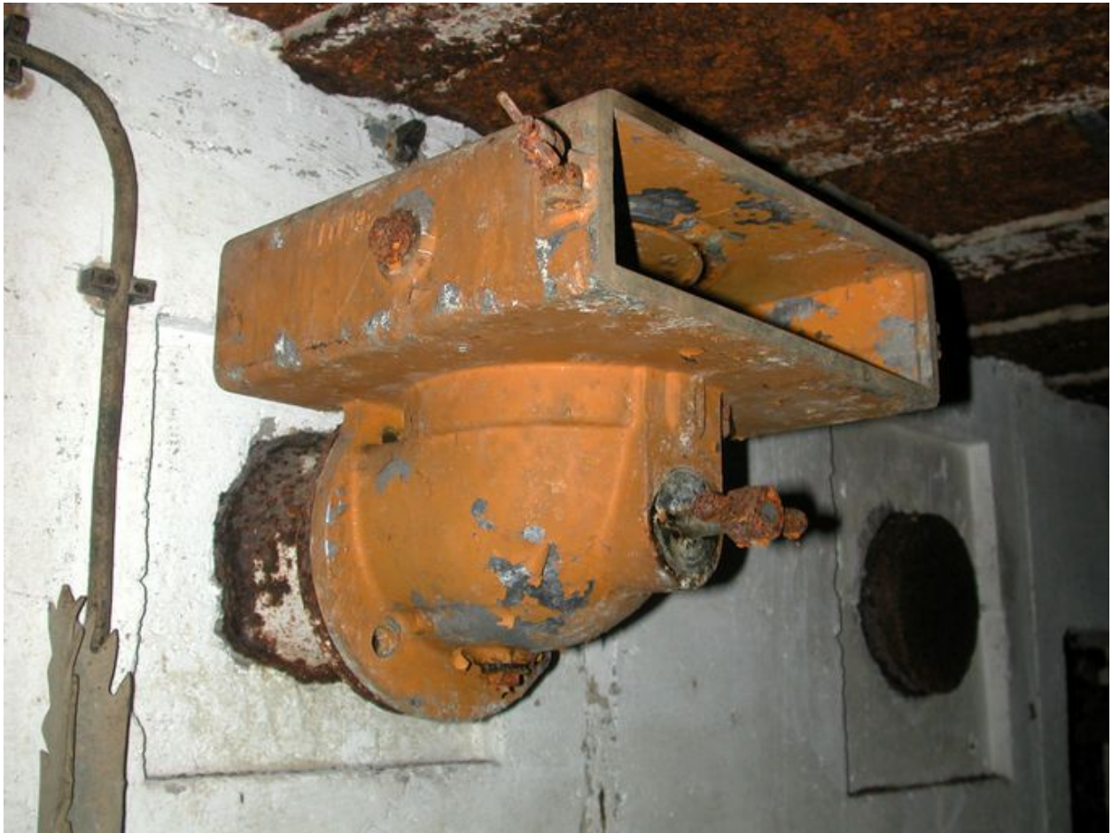
Vue de la chambre de troupe de gauche : filtre dépoussiéreur du système de ventilation (état en 2003)
