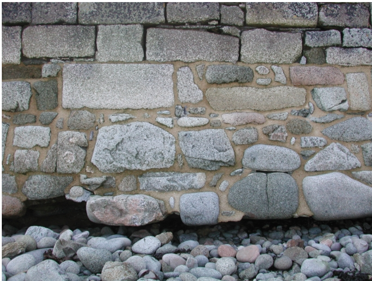
Détails : plage de galets et mur décaissé, attaqué par le ressac
