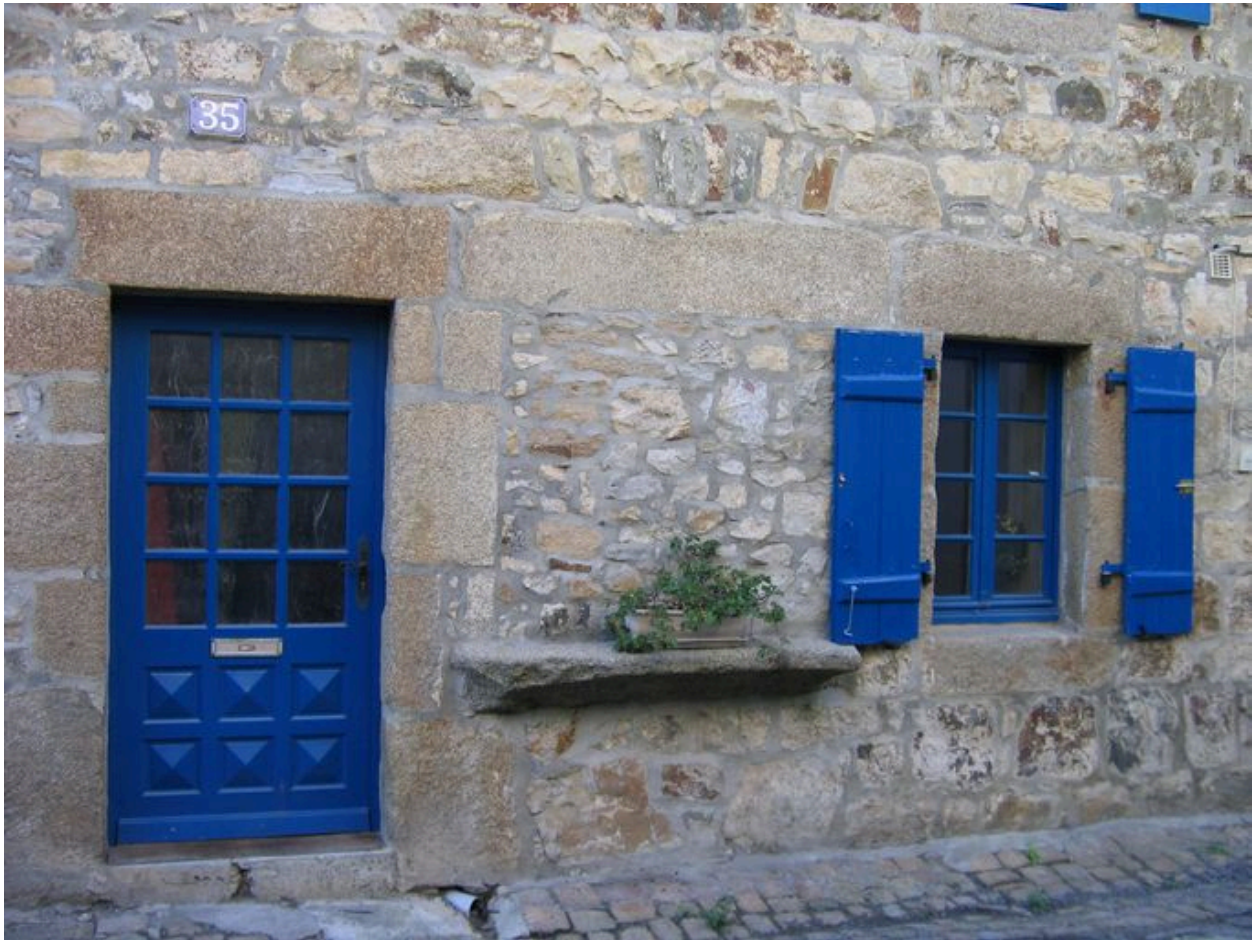
Elévation antérieure, détail de la tablette servant à la vente directe de sardines
