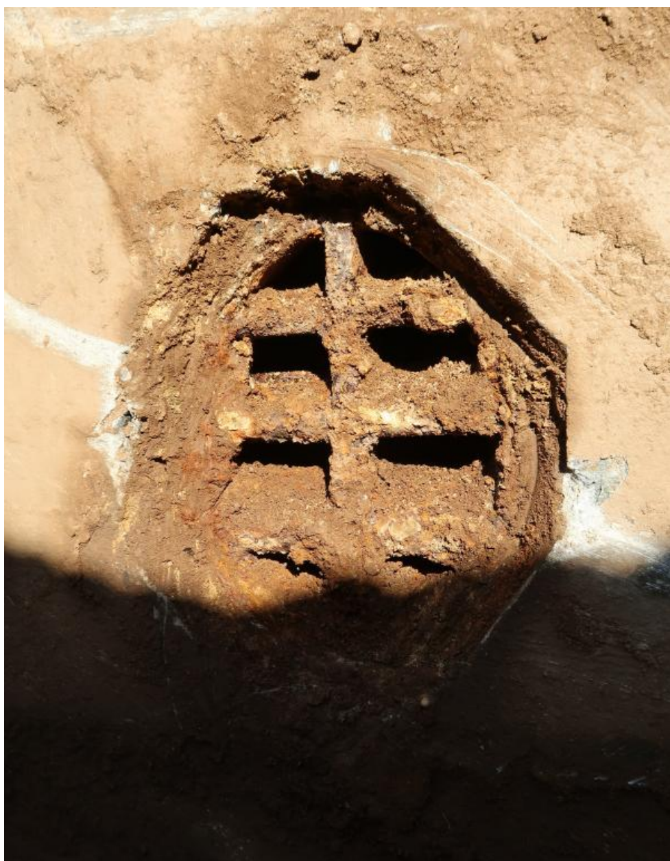
Vue de l'une des bouches de ventilation
