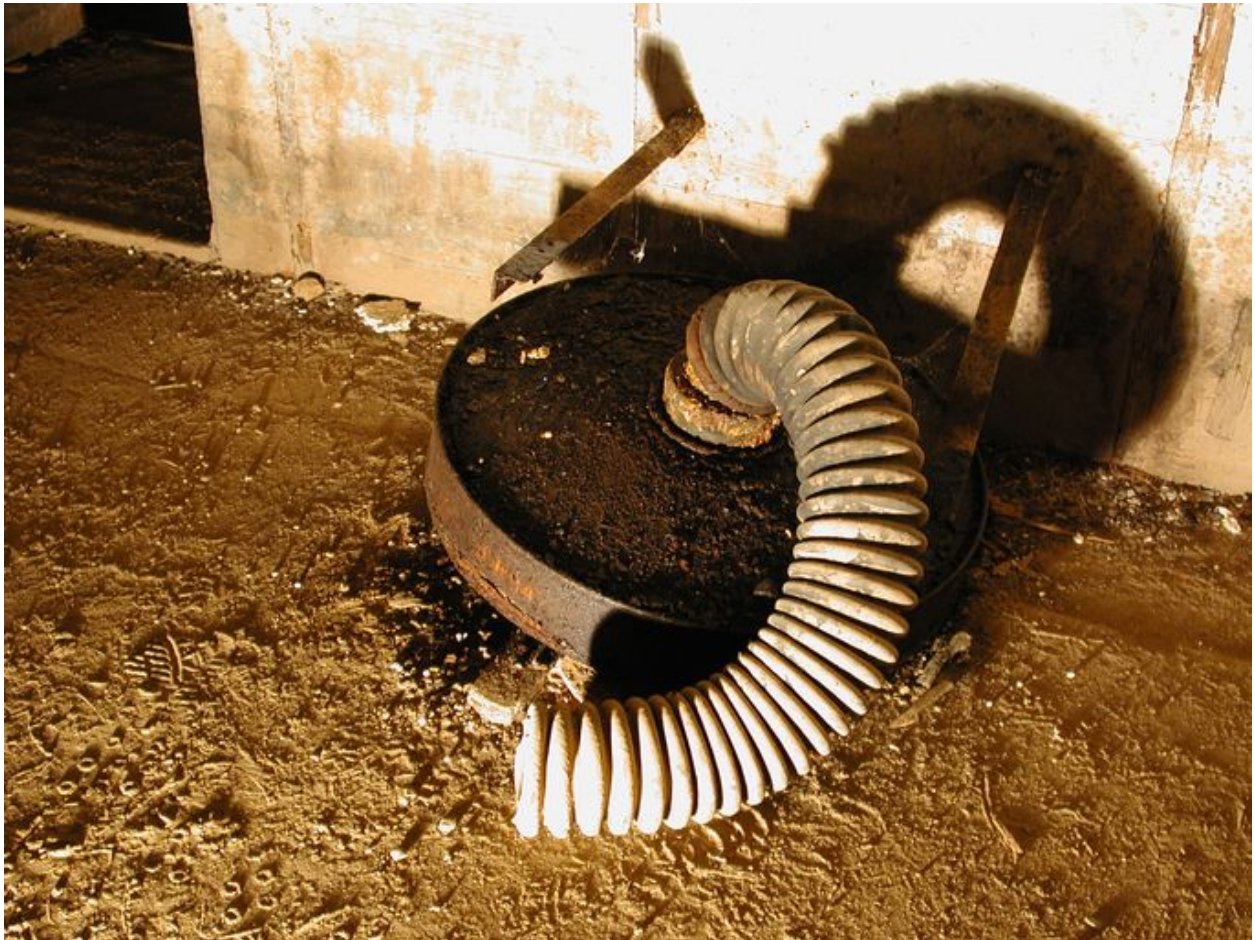
Détail du filtre du ventilateur (à terre)
