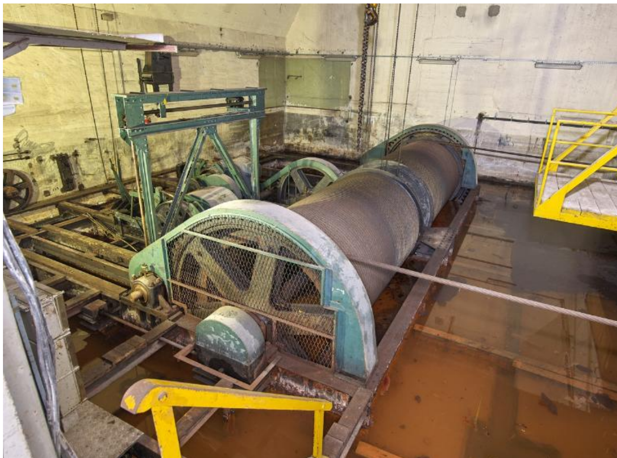
Vue des deux grands tambours pour les câbles de hissage du charriot du slipway. La salle est inondée (état en janvier 2023)
