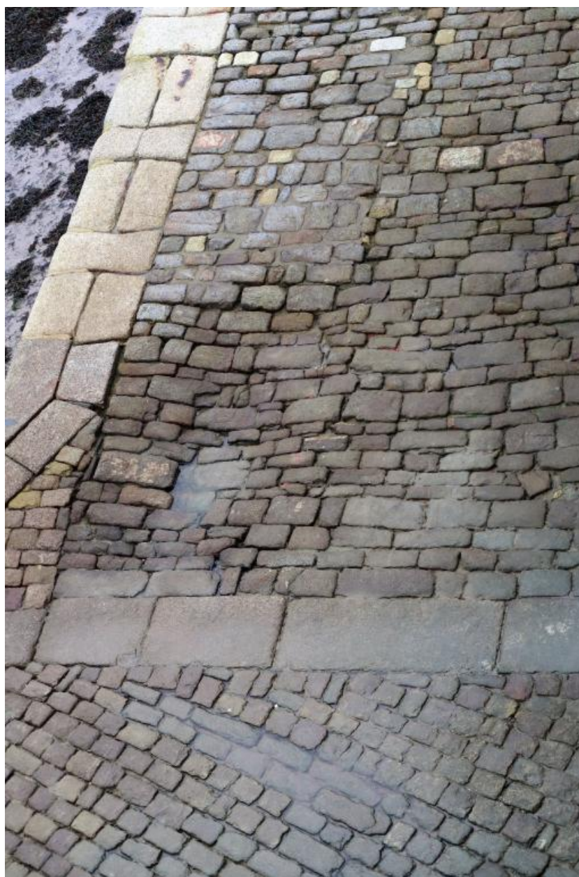
Affaissement du platelage de la cale ouest
