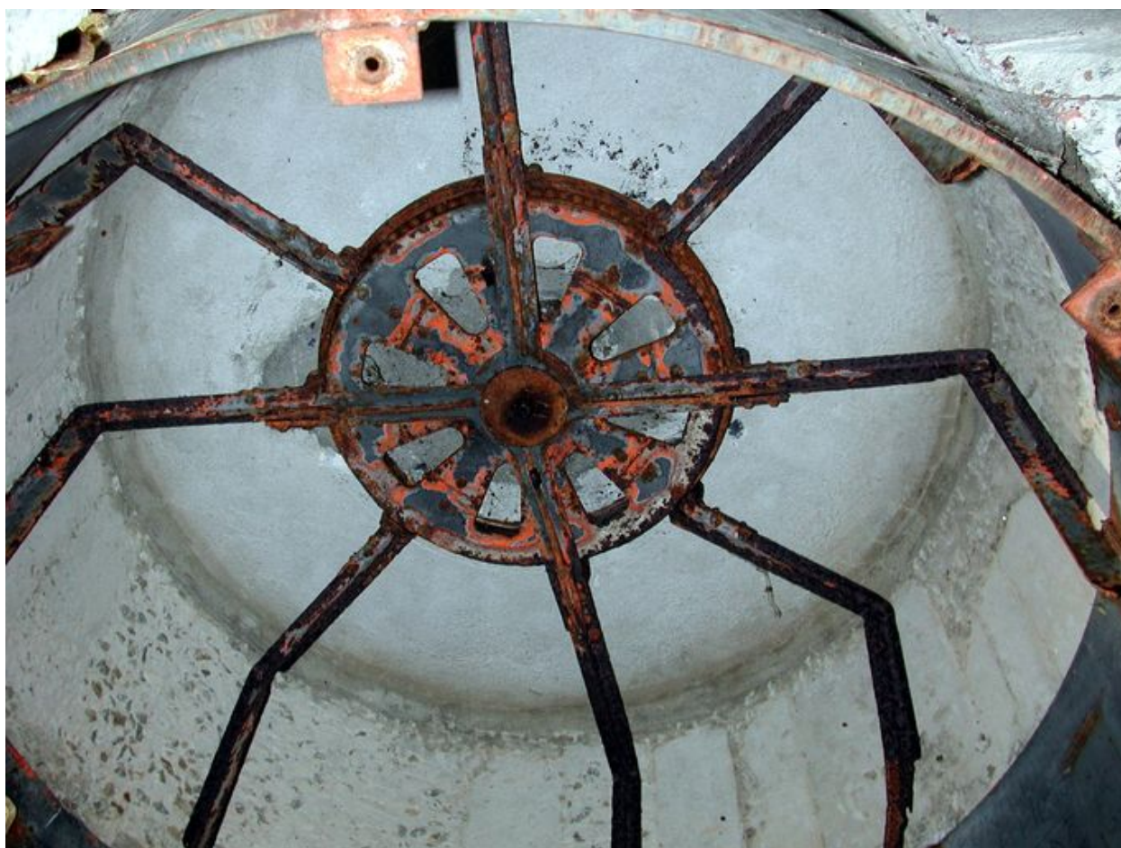
Vue intérieure de l'un des postes d'observation et de télémétrie : bâtiment n° 1 (état en 2007)
