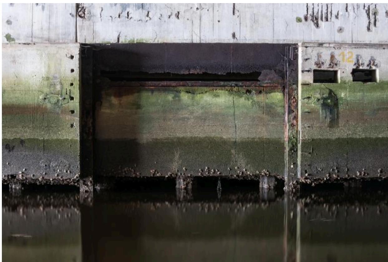
Vue de l'une des deux alvéoles : emplacement de l'un des postes d'amarrage flottant
