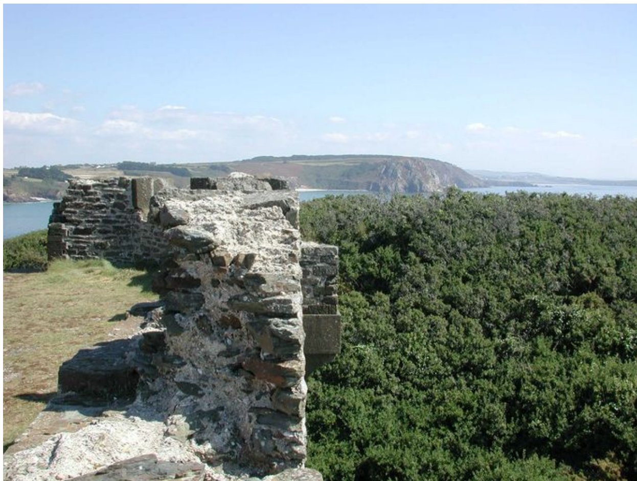
Vue du réduit de batterie de côte de l'île de l'Aber : la batterie extérieure envahie par la végétation
