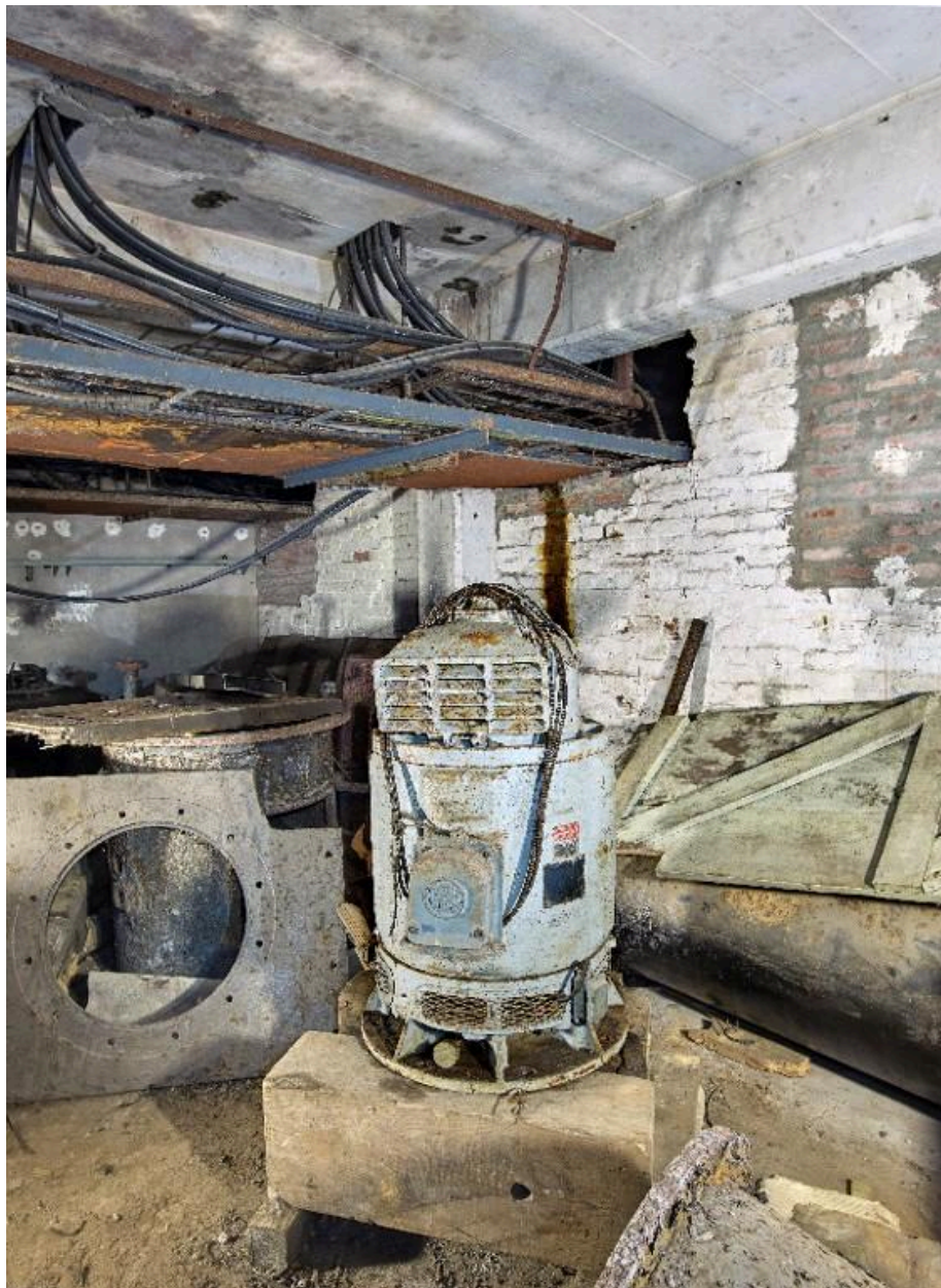
Vue du sous-sol de la centrale électrique : atelier de réparation et magasin de stockage, moteur électrique de pompe avec le logo ACEC des Ateliers de constructions électriques de Charleroi. Suspendu au plafond, chemin de câble électrique
