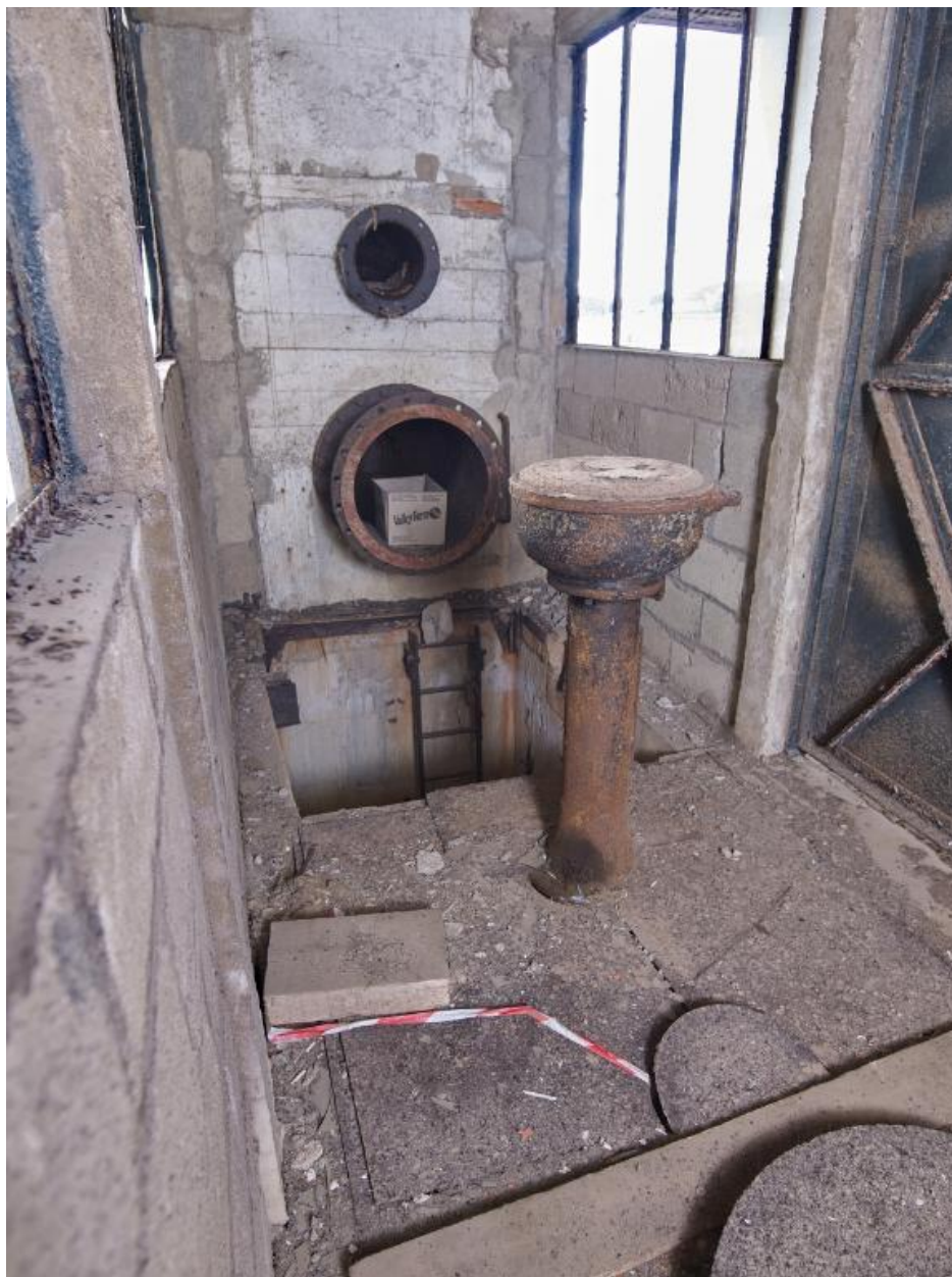
Vue de la salle des pompes de l'algéole D (quai n° 19) : circuit d'eau de pompage intégré dans le mur de refend de l'algéole
