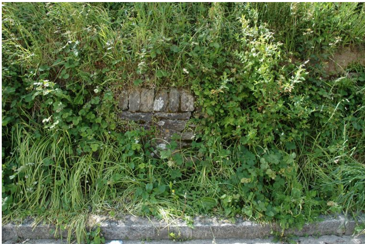
Vue du parc de Keranroux : vestiges de mur en moellon envahi par la végétation (état en 2007)
