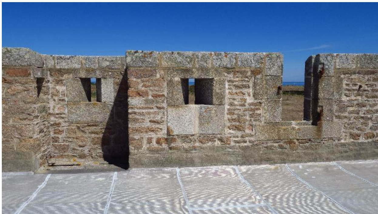
Île-d'Houat, batterie du Béniguet, corps de garde crénelé, détail du parapet de la terrasse.
