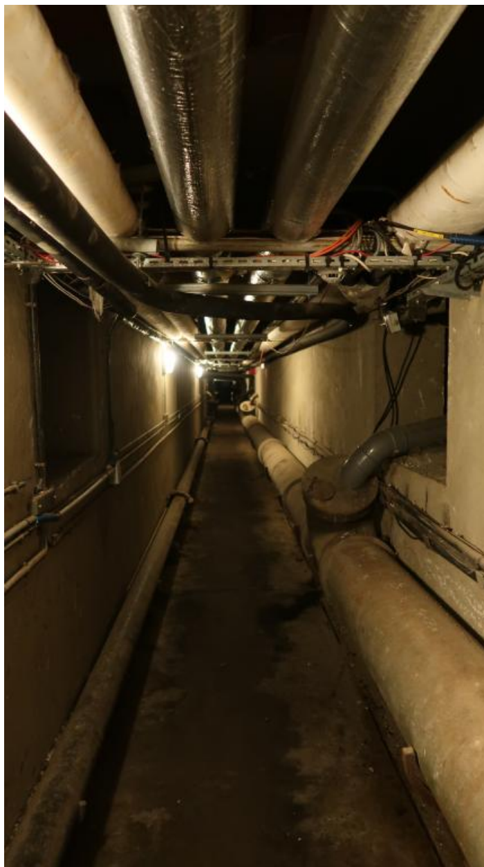
Galerie technique souterraine.
