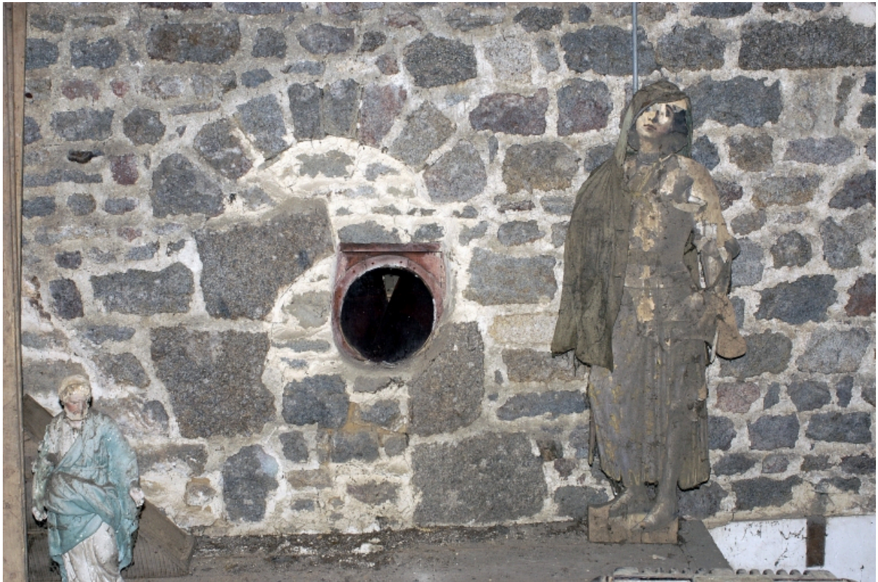
Etage de la sacristie, détail de la maçonnerie du mur est de l'église
