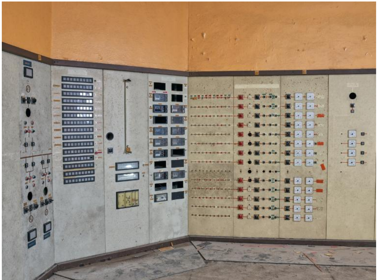
Vue de la salle de commande de la centrale électrique : tableaux n° 24 à 31
