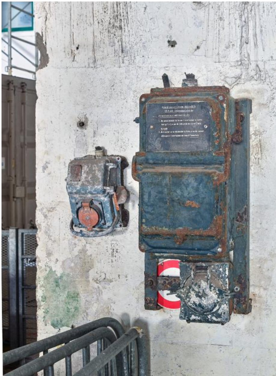
Vue de deux boîtiers électriques. A droite, un boîtier de prise de courant triphasée. Sur le boîtier : informations (380 v 50 Hz 125 A pour compresseurs mobiles) et consignes de sécurité
