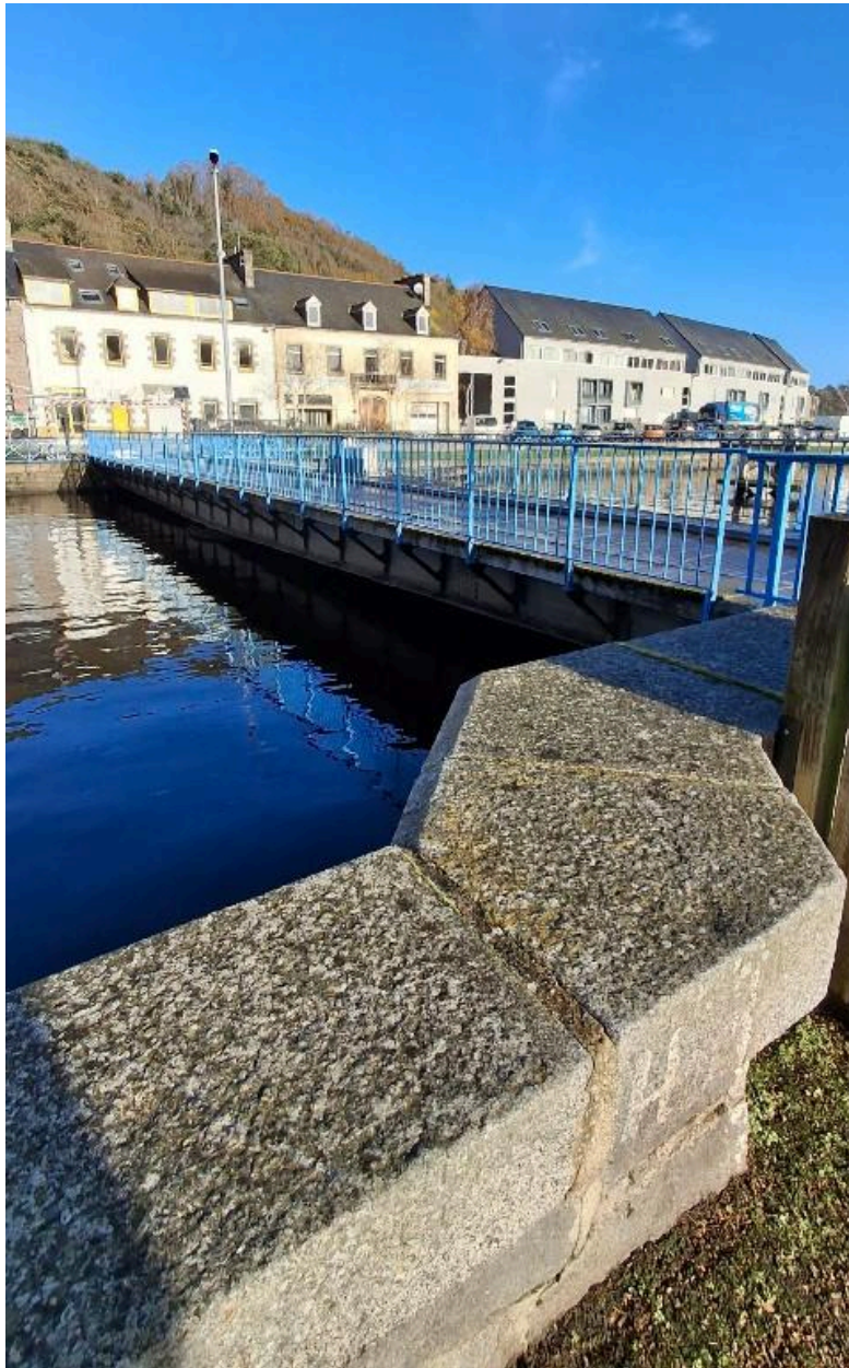
Le pont tournant dans son environnement portuaire et urbain et maçonnerie rive droite
