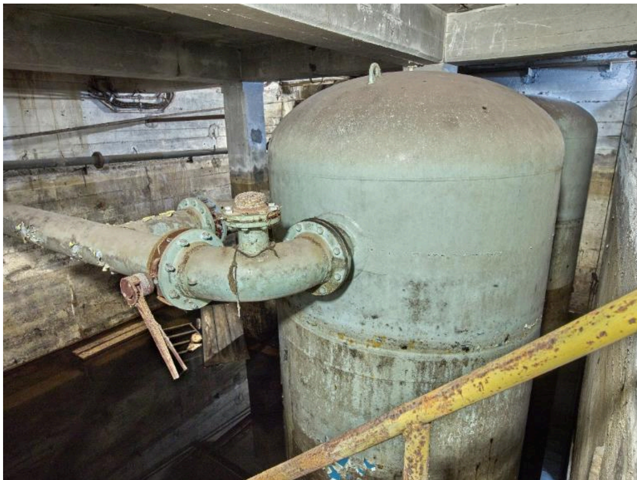
Vue du sous-sol de la salle des groupes électrogènes diesel : extrémité est, deuxième sous-sol, ensemble de deux grands réservoirs
