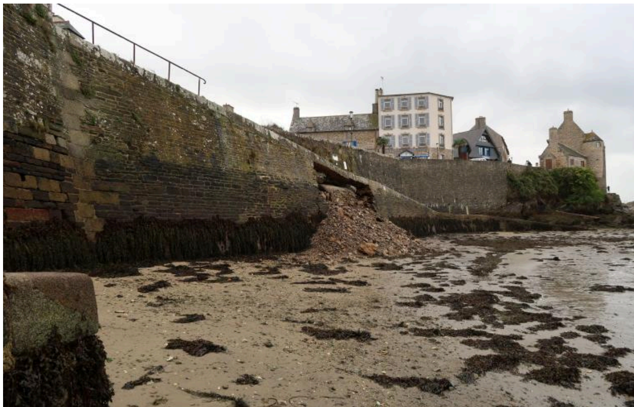
Cale Ouest du Drellac'h : effondrement
