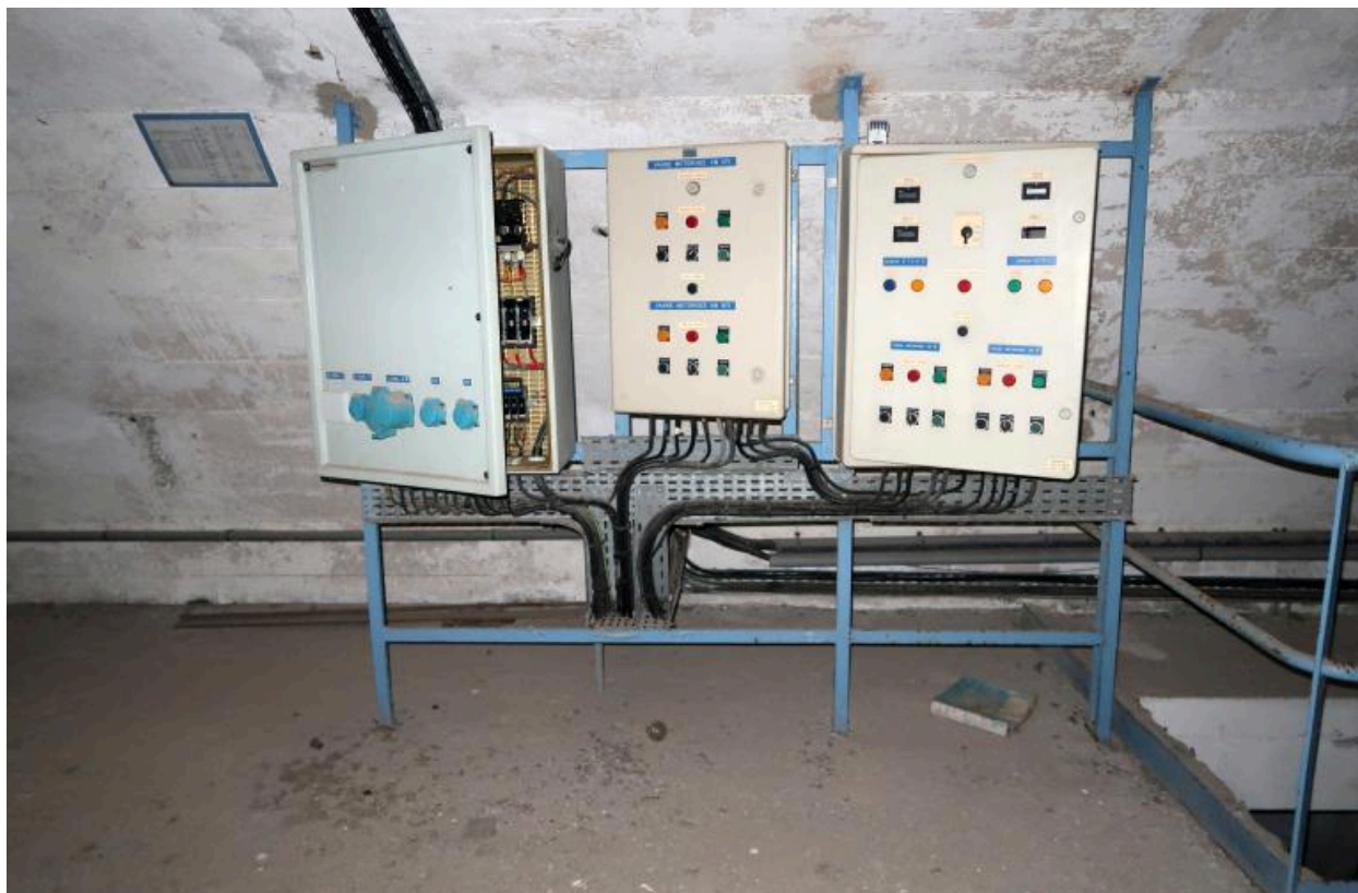
Quatrième étage (cinquième niveau) : tableaux électriques
