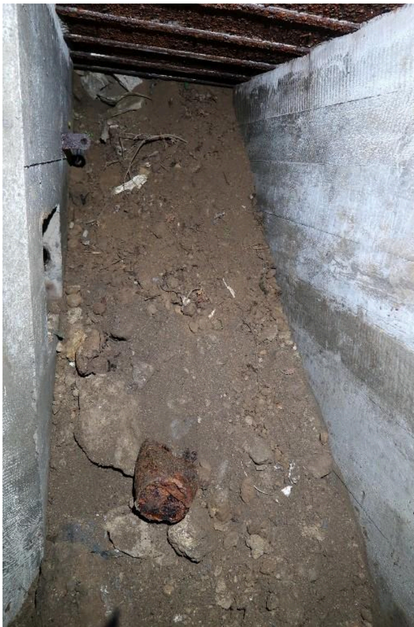
Vue de l'entrée sud obstruée par du remblai
