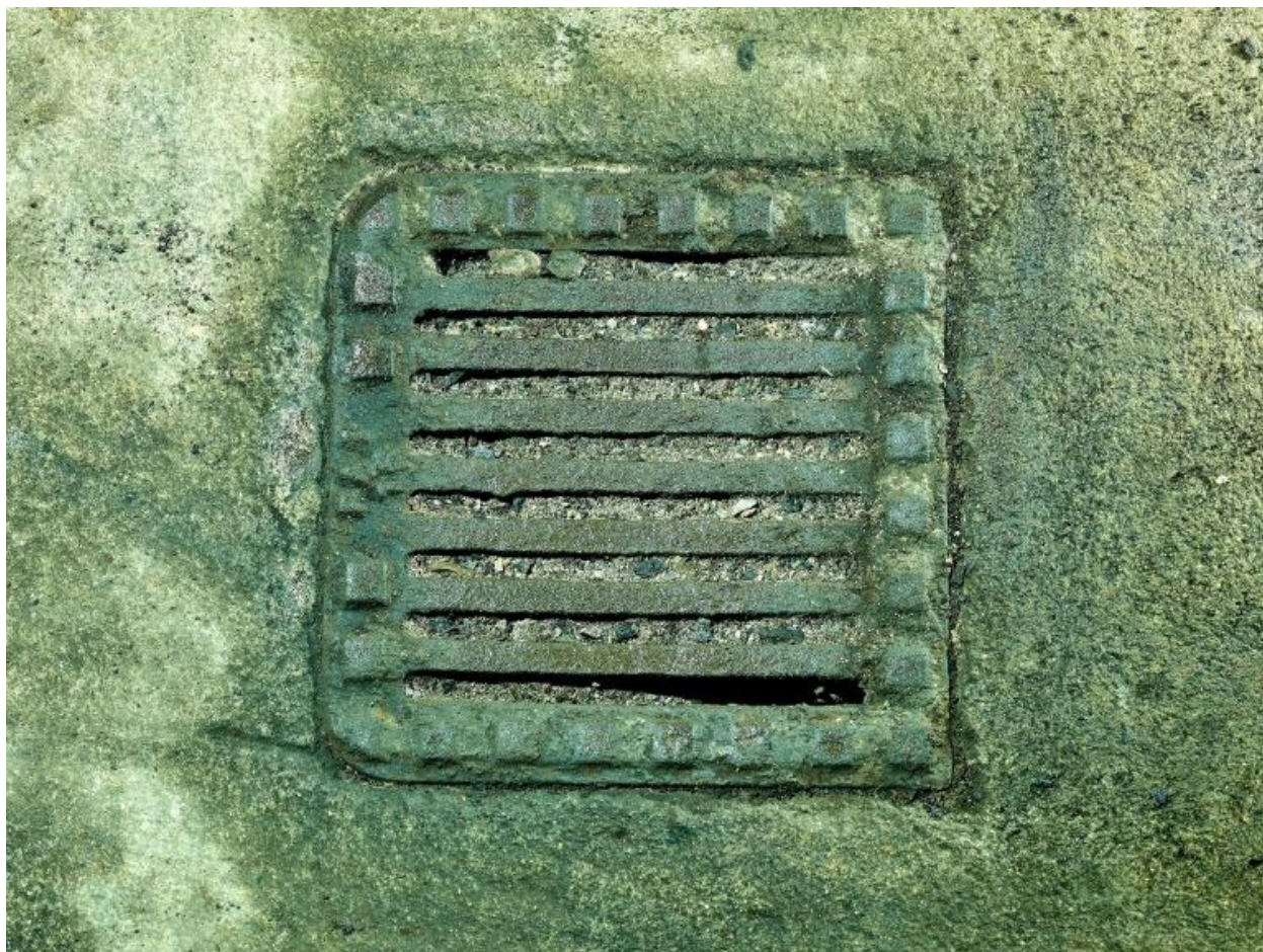
Vue de la salle des ventilateurs, grille de l'exutoire aménagé dans le sol pour le nettoyage
