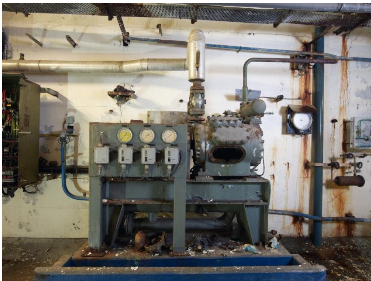
Machines (partie nord)
