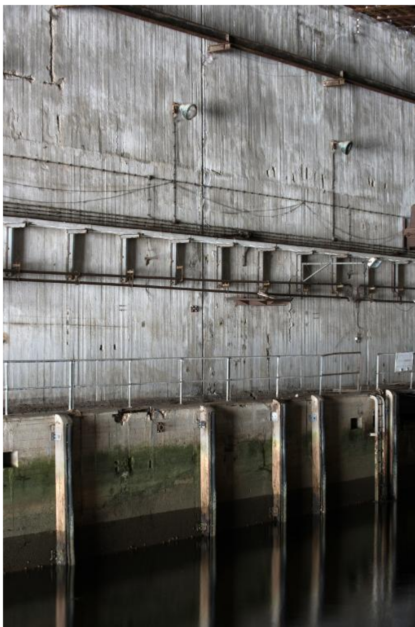
Vue de l'une des deux alvéoles : défenses de quai en bois. Sur le mur, chemin de câble et lampes murales
