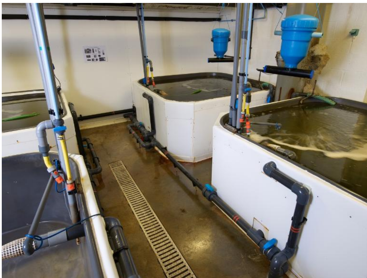
Ferme aquacole : vue d'un atelier et de bassins d'élevage.
