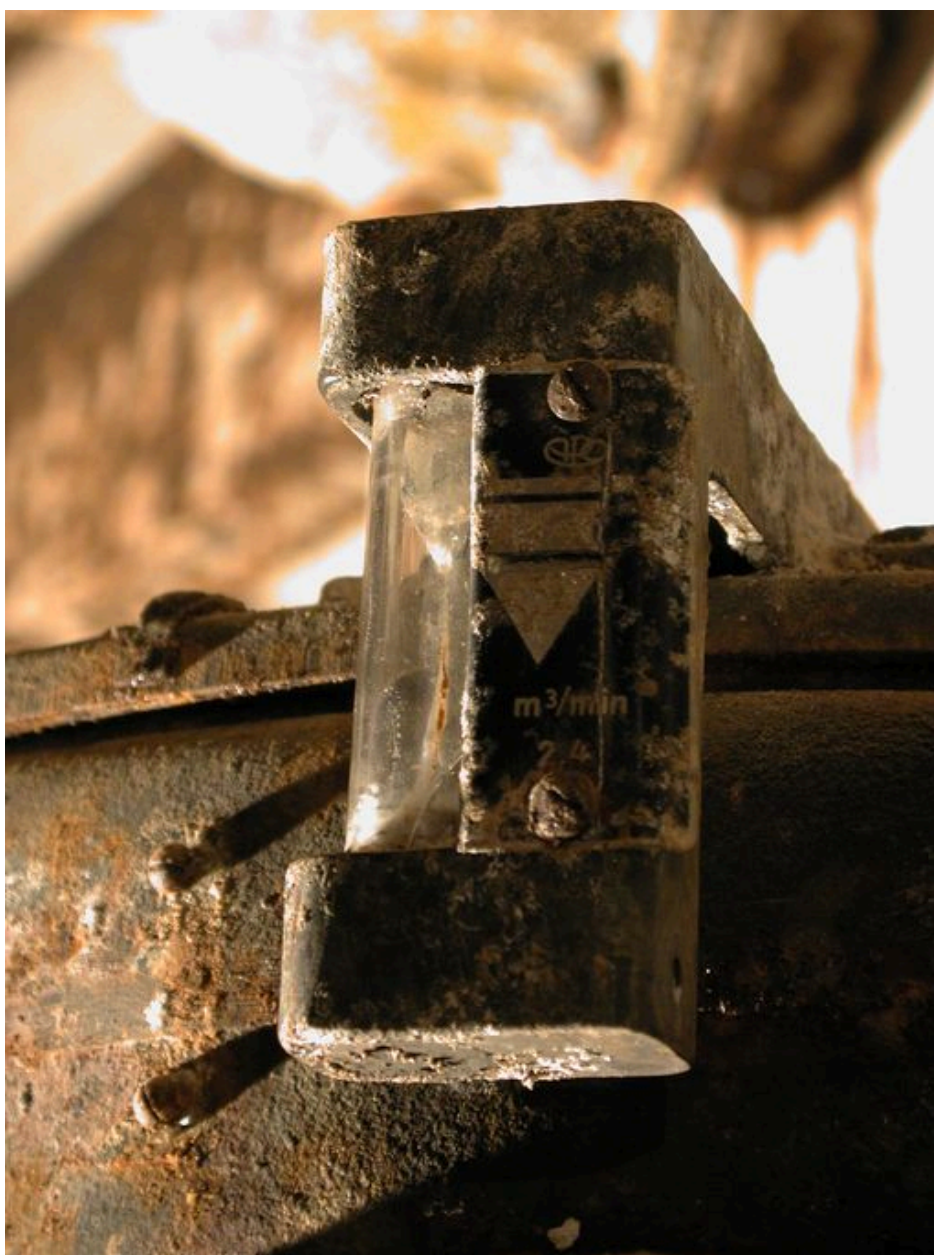
Détail du ventilateur : débitmètre
