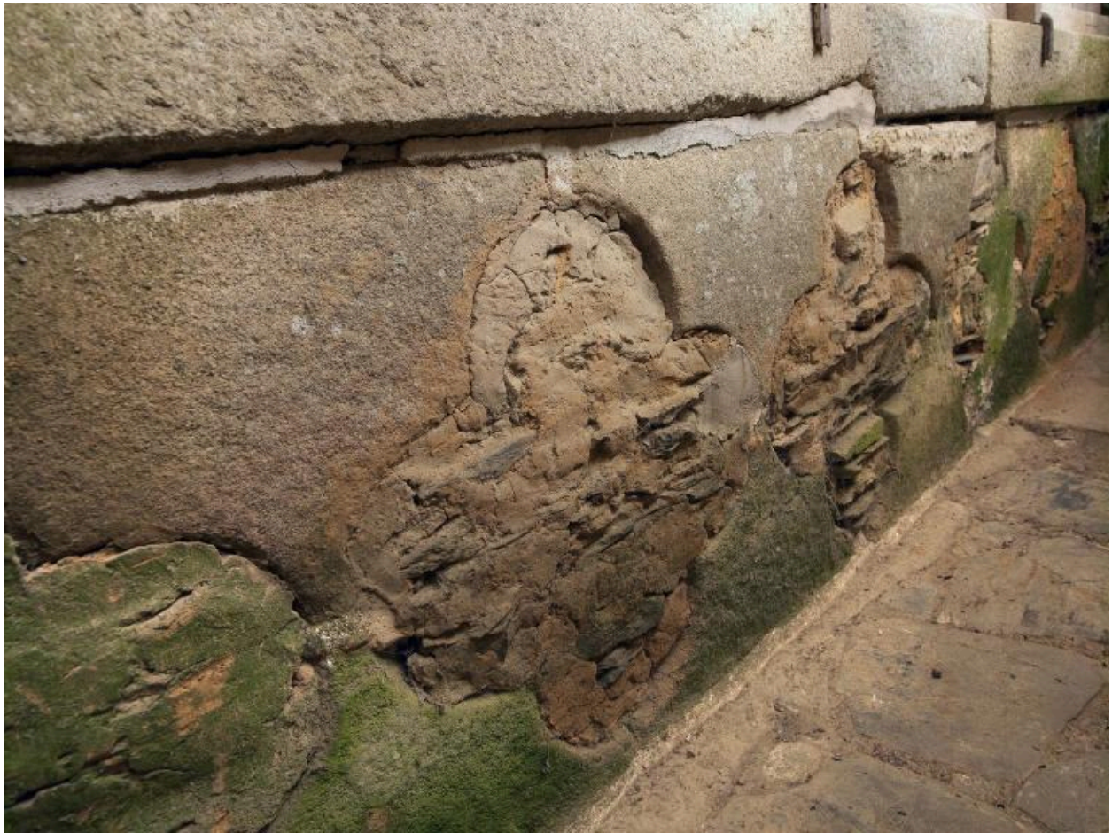
Revers de l'ancienne tribune dissimulée derrière le buffet d'orgue. Détail des motifs quadrilobés bouchés
