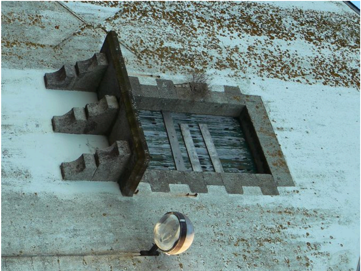
Balcon d'un des bâtiments nord de l'ancienne conserverie Capitaine Cook, donnant sur la ria
