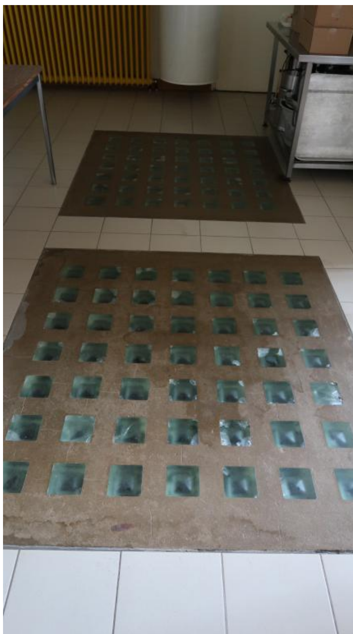
Système d'éclairage des caves de la cuisine : béton et pavés de verre (G-R. Lefort, architecte, 1936-1938).
