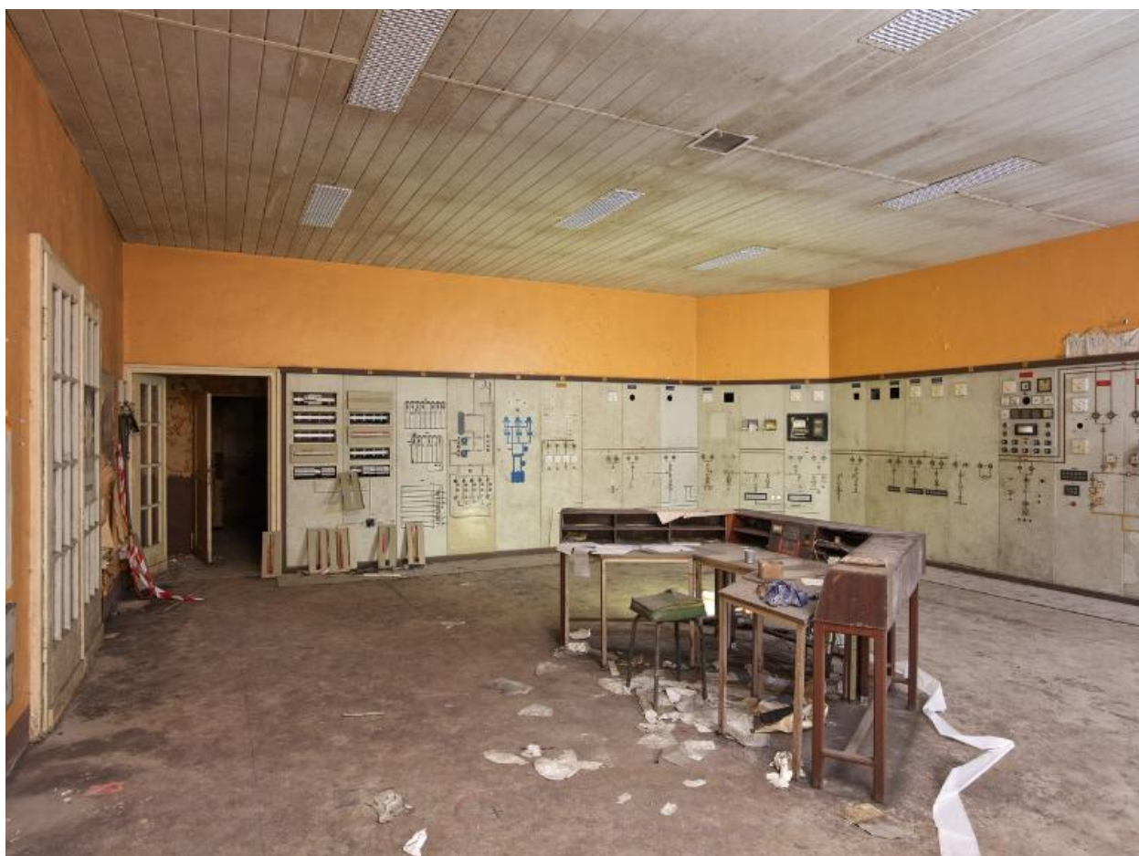
Vue de la salle de commande de la centrale électrique. Au centre, le bureau
