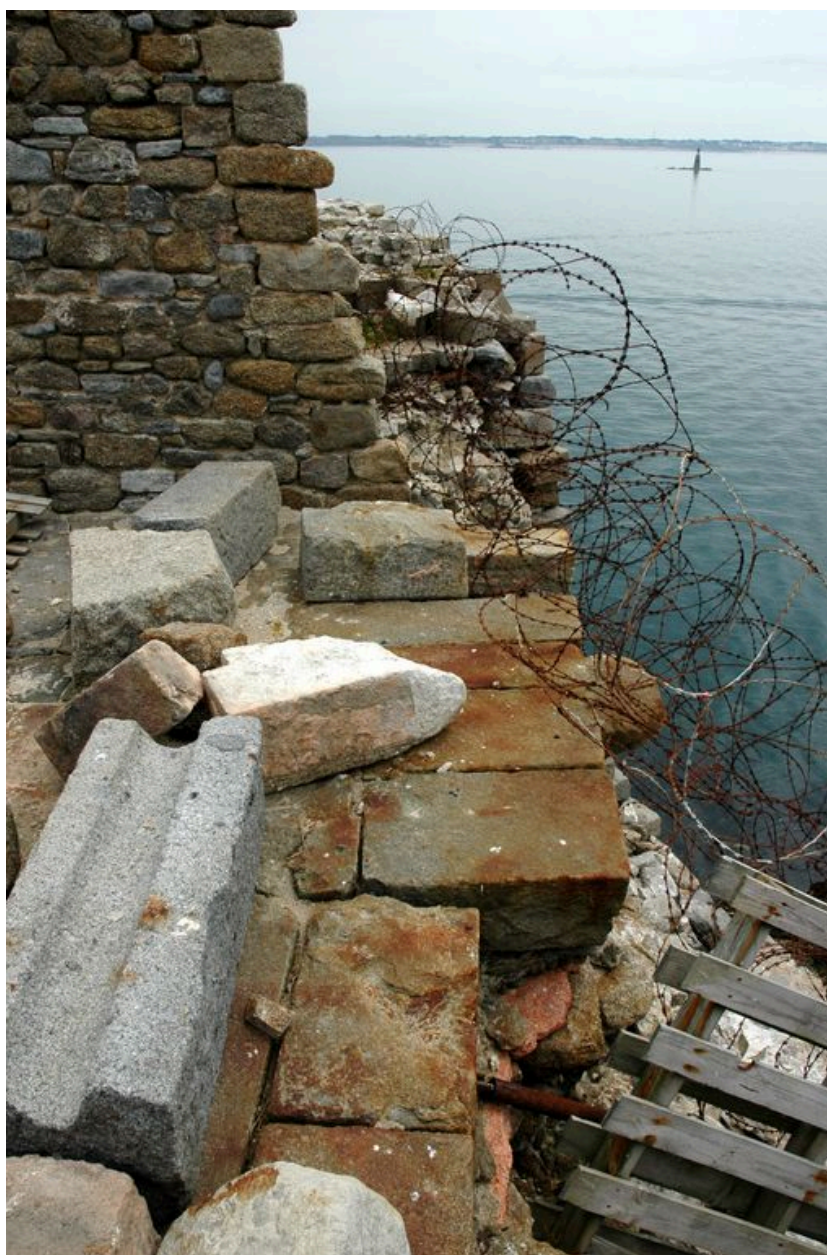
Vue du fort de la Conchée : parapet sud et dallage de la terrasse en cours de restauration
