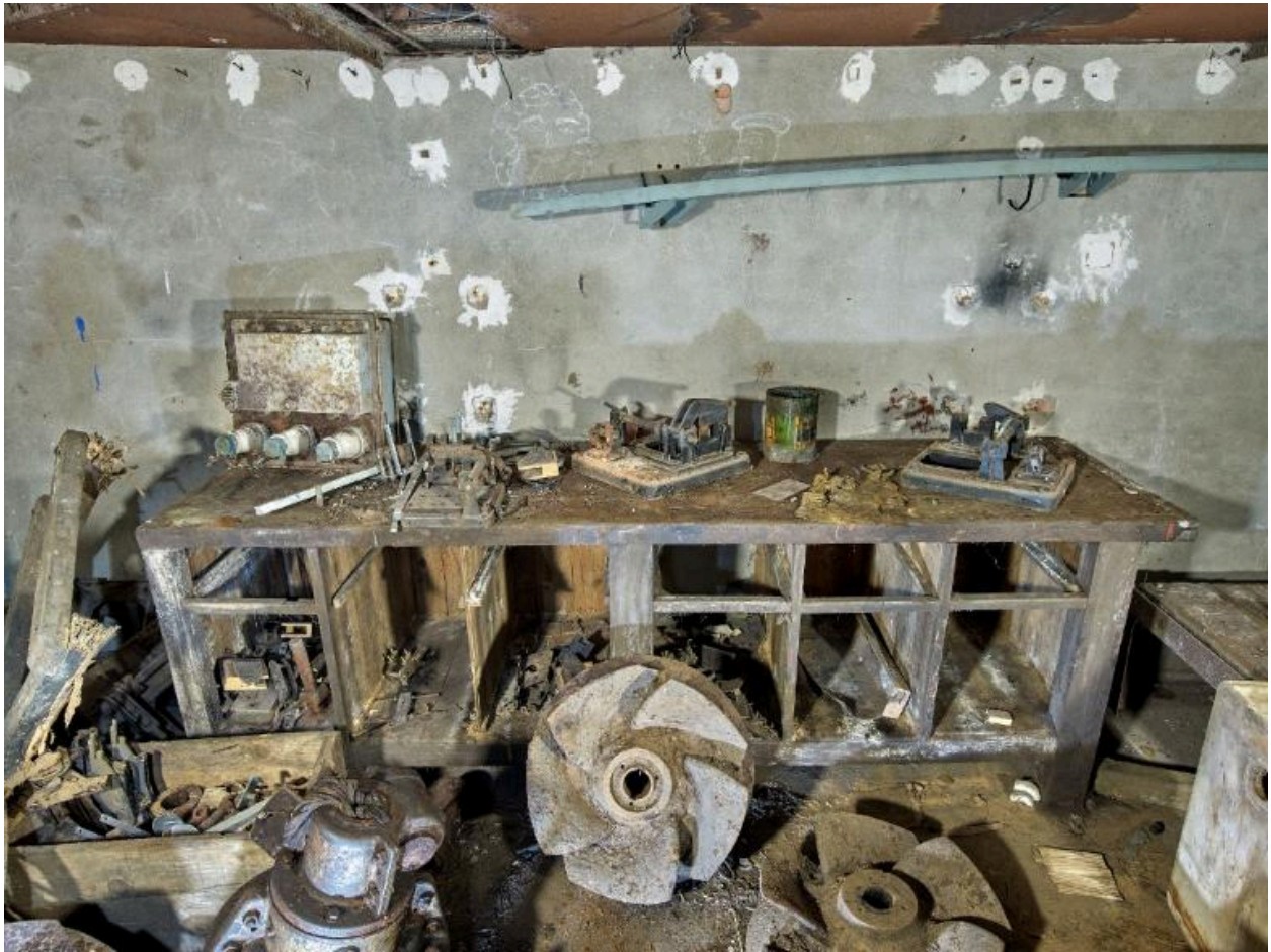
Vue du sous-sol de la centrale électrique : atelier de réparation et magasin de stockage, établi en bois et pièces diverses
