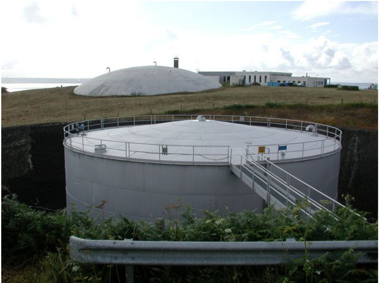
Vue du parc à carburant de Maison Blanche : cuve métallique
