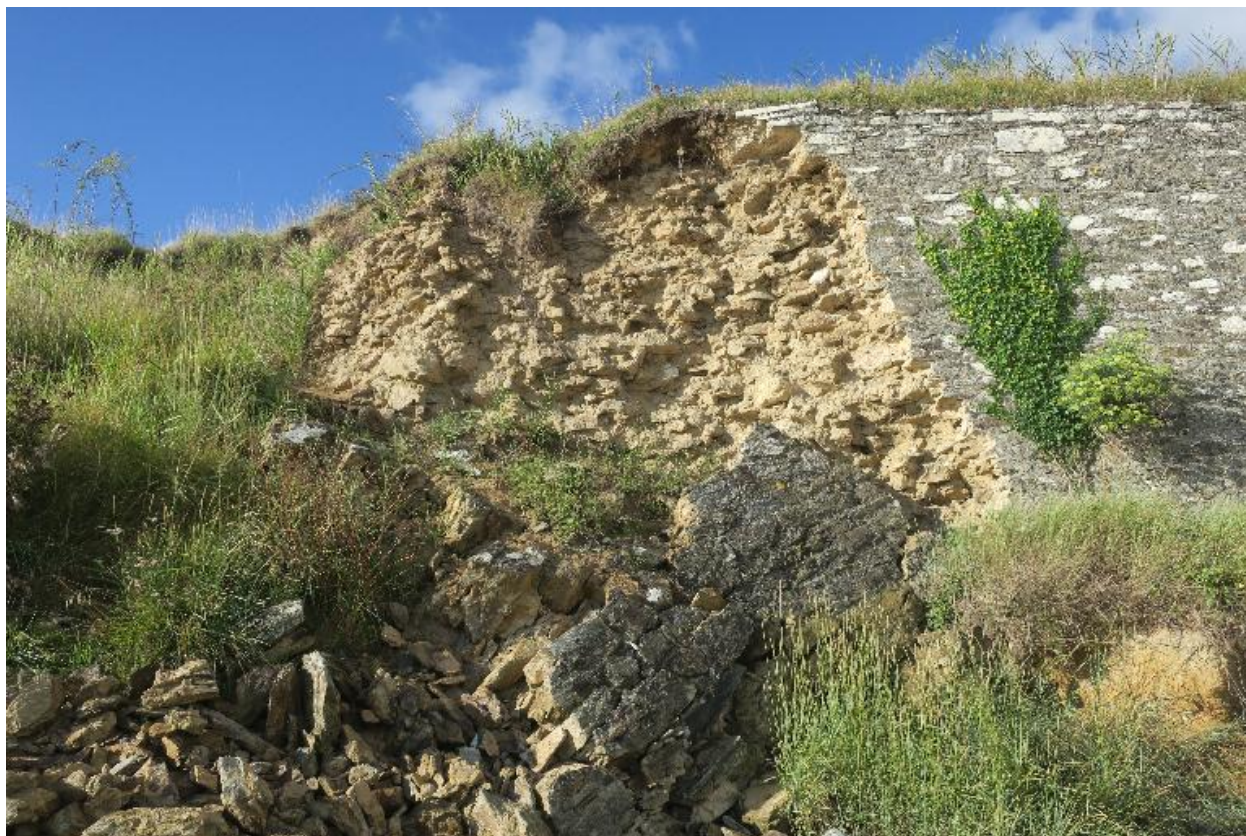
Locmaria, Grands Sables, dégâts sur l'escarpe.
