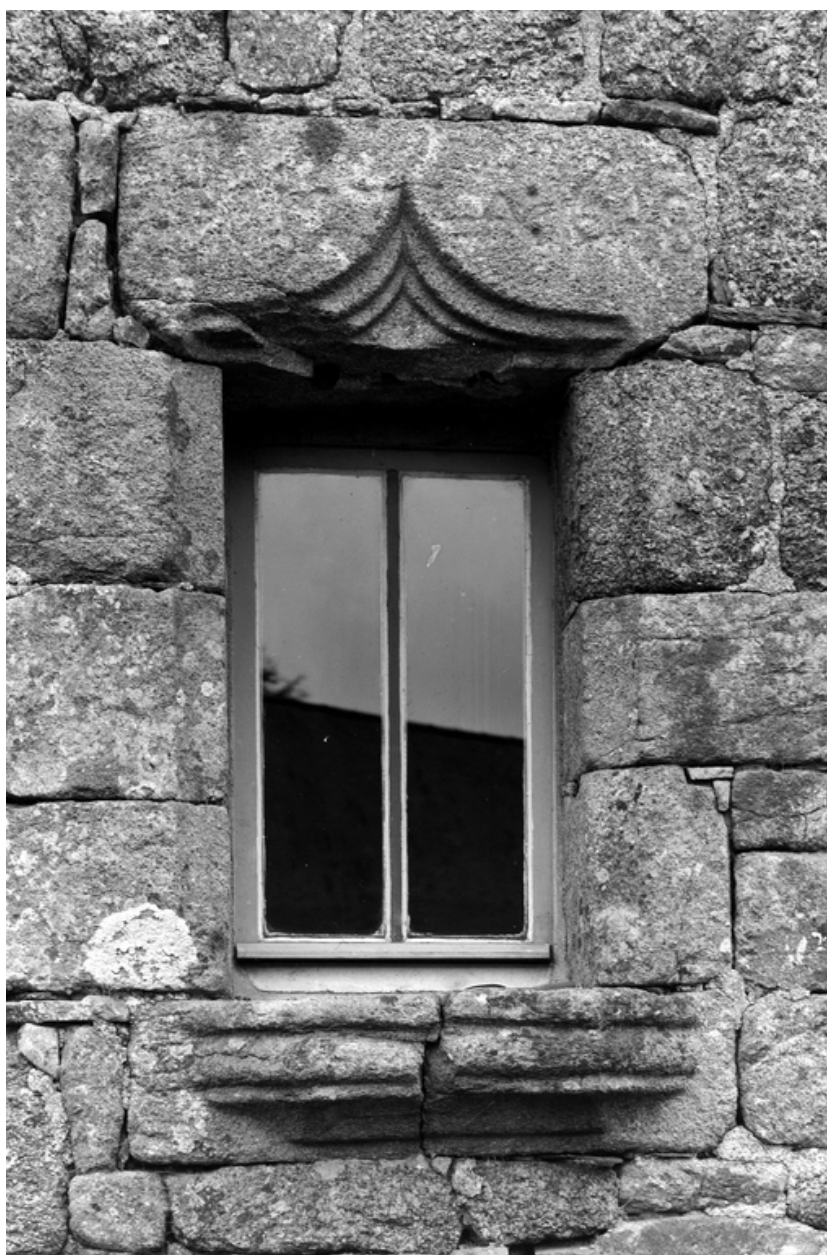
Façade sud, détail : linteau de la fenêtre est du rez-de-chaussée
