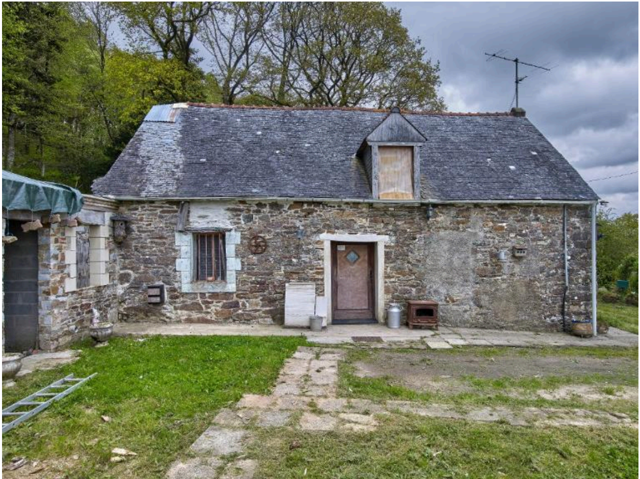
Vue générale sud. Porte et jour bouchés à droite (ancienne dépendance transformée en chambre)
