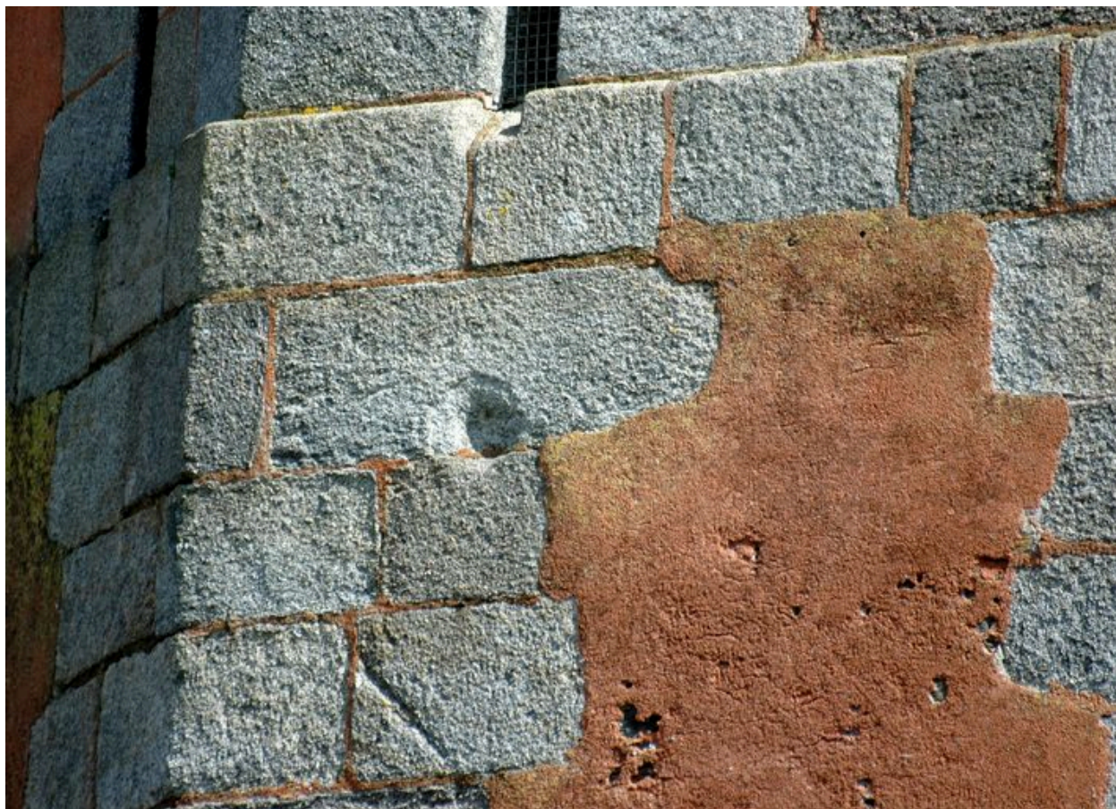
Vue de la Tour Vauban : impacts de boulets sur la face occidentale de la tour
